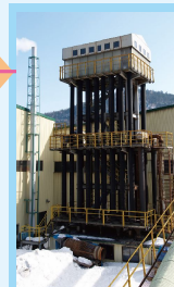
コンデンサータワー
